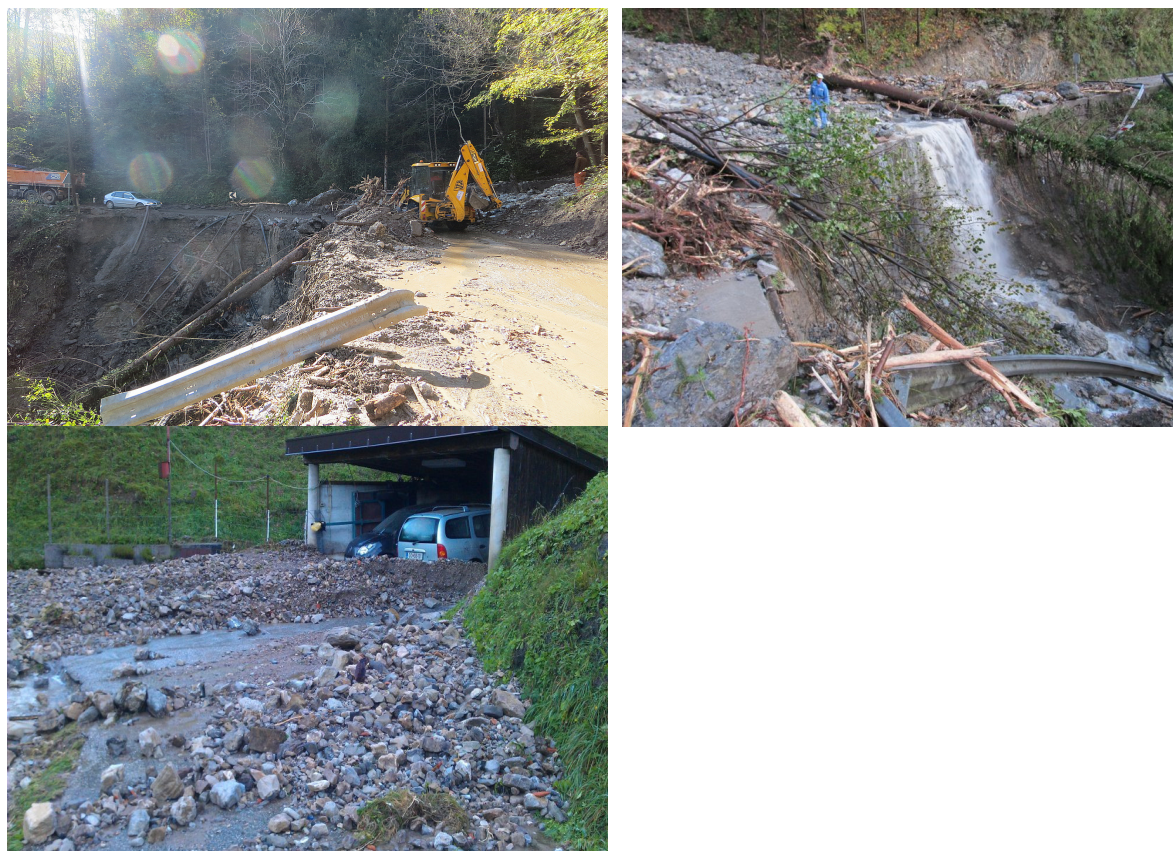
Slika 5: Hudourniške vode so močno poškodovale ceste v Posočju (Baška grapa, Grahovo ob Bači, Temljine v Baški grapi) (Vir: MMC).
